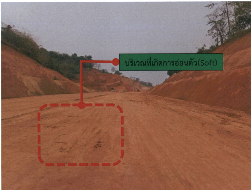
รูปที่ ๑ การอ่อนตัวของชั้นดินเดิม บริเวณ กม.๑๐+๔๐๐.๐๐๐
