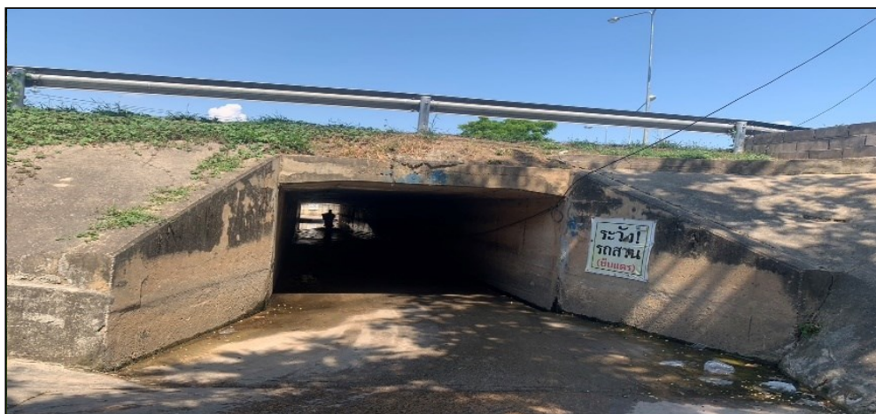
รูปที่ 3-2 แบบ Box Culvert ขนาด 1- 2.40 x 1.90 ม. (สทล.ที่ 15 ทล.4 กม.ที่ 162+430)
