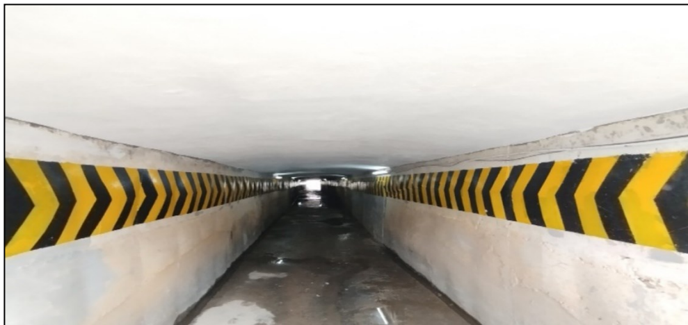
รูปที่ 3-1 แบบ Box Culvert ขนาด 1- 2.10 x 2.10 ม. (สทล.ที่ 15 ทล.4 กม.ที่ 263+340)
