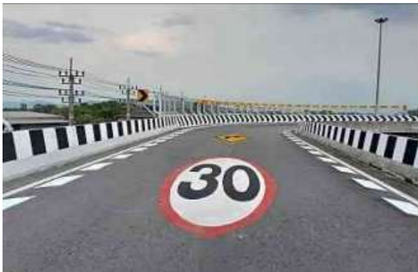
รูปที่ 3-20: สะพานกลับรถเกือกม้า ทล.414 กม.1+560 แขวงทางหลวงสงขลาที่ 1 ภายหลังจากปรับปรุง
