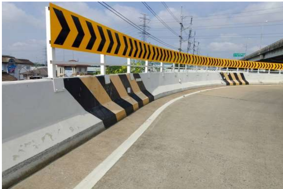
รูปที่ 3-3: ตัวอย่างราวกันตกสำหรับรถจักรยานยนต์ที่หน่วยงานดำเนินการติดตั้งไปก่อนในบางพื้นที่
