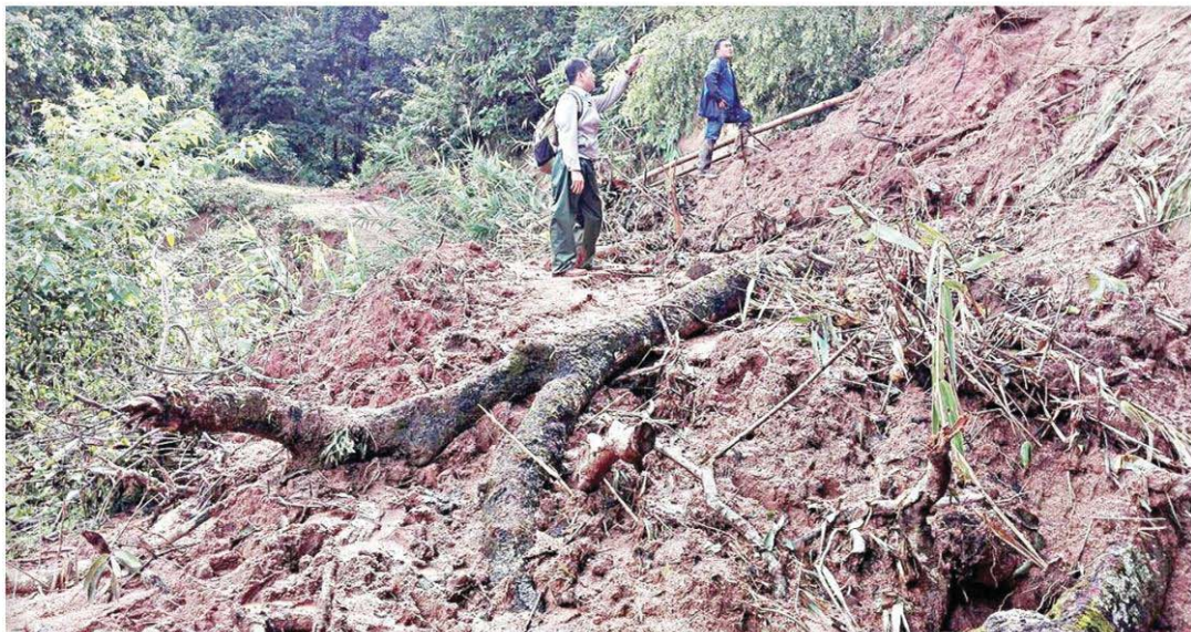
▲ ดินสไลด์...ฝนที่ตกหนักอย่างต่อเนื่องทำให้เกิดดินสไลด์ไหล่ทางทรุด ต้นไม้หักโค่นปิดทับเส้นทางระหว่างบ้านแม่ ปุ่น-บ้านห้วยเตี๋ อ.แม่สะเรียง จ.แม่ฮ่องสอน ทำให้ราษฎร 2 หมู่บ้านกว่า 300 หลังคาเรือนถูกตัดขาดจากโลกภายนอก
