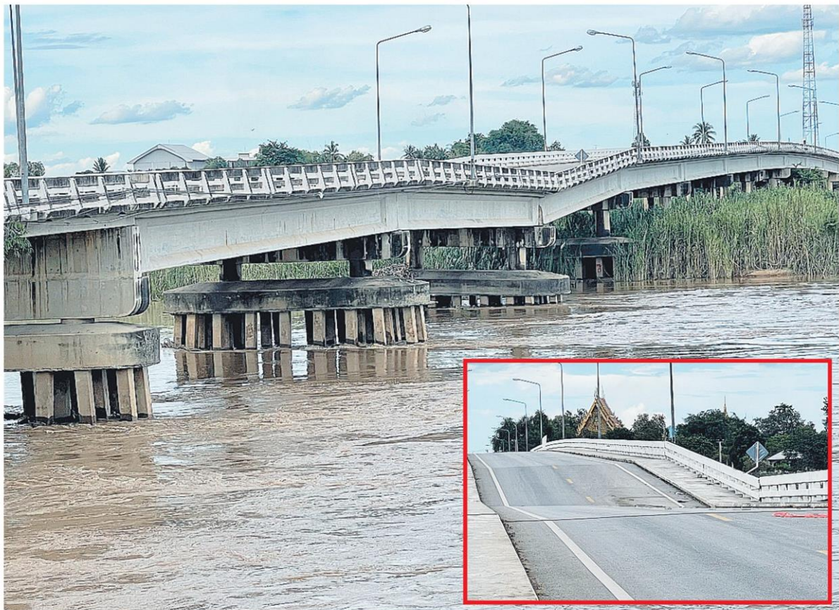
▲ รวันถล่ม สภาพสะพานศรีมงคลวรานุสรณ์ (สะพานวังแฉม) ข้ามแม่น้ำปึงเชื่อมโยงระหว่าง ต.วังแฉม กับ ต.แม่ลาด อ.คลองขลุง จ.กำแพงเพชร ที่กลางสะพานทรุดตัวอย่างหนัก (ภาพเล็ก) หลังถูกกระแสน้ำแม่ปึงซัดตอม่อทรุดจนอาจถล่มได้ และต้องปิดใช้งานถาวร รวมถึงห้ามเดินไปมาเด็ดขาด.
