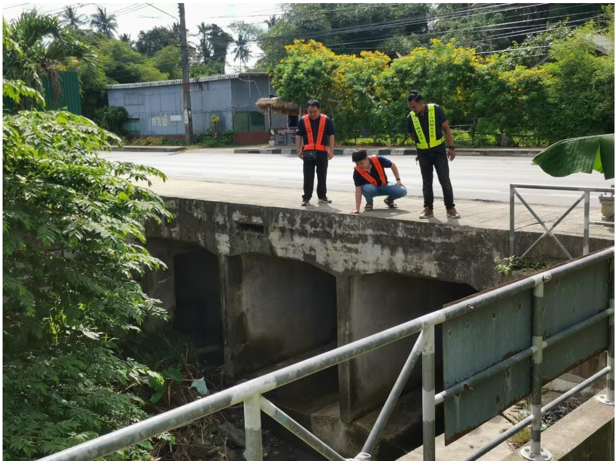
รูปที่ 10-8 สะพานข้ามคลองพงแพ บริเวณ กม.40+000 ไม่มีราวกัน
