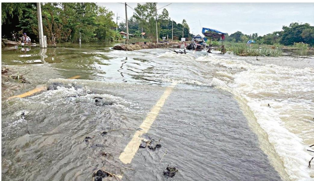
▲ คันดินพัง... กระแสน้ำเชี่ยวกรากพัดแนวคันดินป้องกันน้ำท่วมพังทลายล้มทับถนน พื้นที่หมู่ 4 ต.บ้านหม้อ อ.พรหมบุรี จ.สิงห์บุรี มีมวลน้ำจากแม่น้ำเจ้าพระยาไหลลงคลองชลประทานสร้างความเสียหายเป็นบริเวณกว้าง
