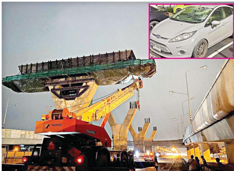
▲ ซ้ำซาก...สถานที่ก่อสร้างบริเวณถนนพระราม 2 เกิดฝนตกหนักน้ำขังผ้าใบใช้ป้องกันอุบัติเหตุระหว่างการก่อสร้างหล่นใส่รถแก๊งฟอร์ด ทะเบียน ญท 4507 กรุงเทพมหานคร (ภาพเล็ก) พังเสียหาย
