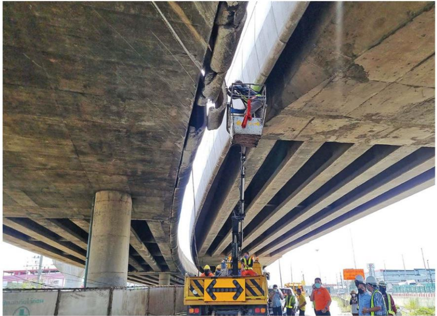
🏠 เก็บก่อนรุ่ง - เจ้าหน้าที่แขวงทางหลวงสมุทรสาคร ขึ้นซ่อมแซม แผ่นดินขอบทางสะพานต่างระดับเอกชัย-บางบอน จ.สมุทรสาคร หลังมี ผู้โพสต์สภาพแผ่นดินชำรุดกลัวหล่นร่วงลงมาถูกรถด้านล่างชำรุดสะพาน พระราม 2 ถล่ม เมื่อวันที่ 3 ส.ค.
