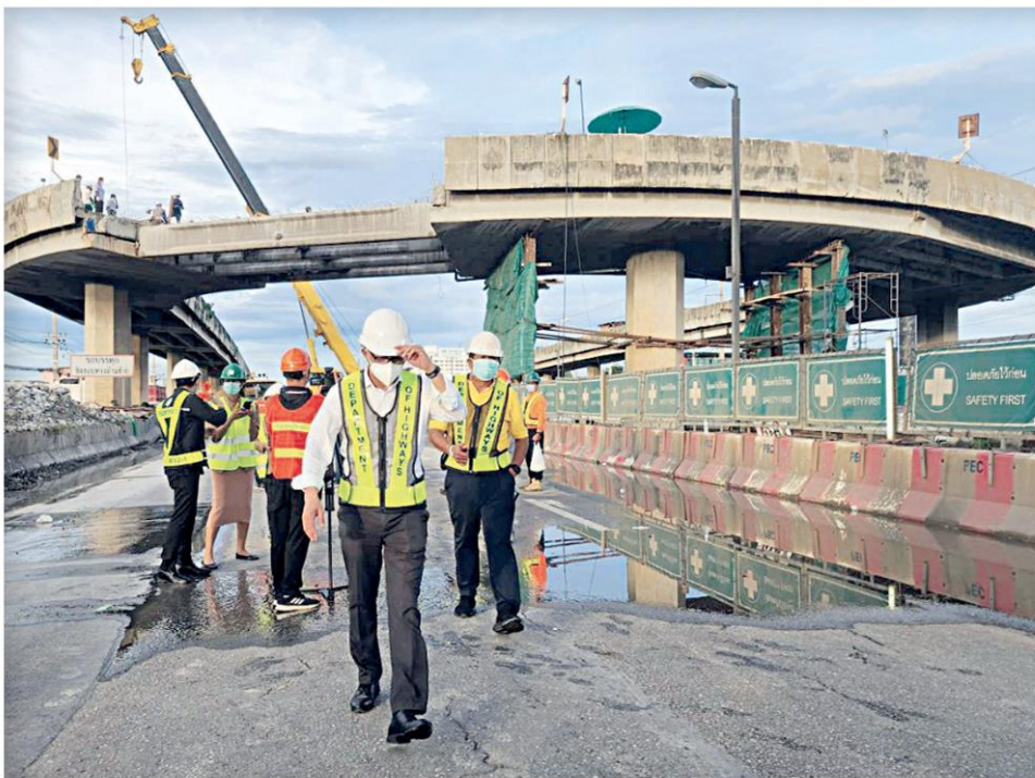
▲ ตรวจสอบ...นายสรราช ทรงศิริไล อธิบดีกรมทางหลวง (ทล.) พร้อมคณะเข้าตรวจสอบสถานที่เกิดเหตุคานเกือบกลับรถพังถล่ม ที่ถนนพระราม 2 บริเวณหน้า รพ.วิภาวธรรม ขาเข้ากรุงเทพฯ จ.สมุทรสาคร
