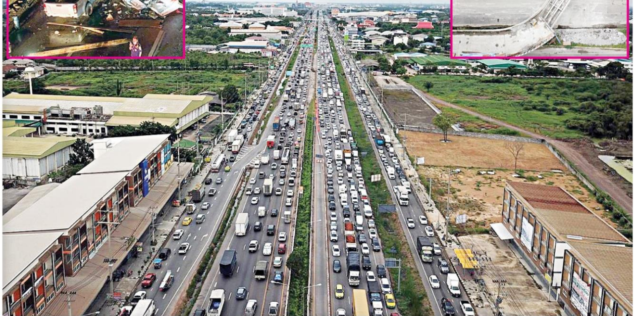
▲ ติดยาว... สภาพการจราจรบนถนนพระราม 2 ติดยาวเหยียดทั้งขาเข้า-ขาออก หลังเกิดอุบัติเหตุลานสะพานกลับรถ กม.34 ถนนพระราม 2 บริเวณหน้า รพ.วิภาวดี ขาเข้ากรุงเทพฯ จ.สมุทรสาคร ที่อยู่ระหว่างการซ่อมแซมได้หล่นทับรถยนต์ (ภาพเล็ก) มีผู้เสียชีวิต 2 บาดเจ็บ 2
