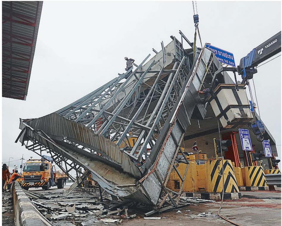
หลังคาคถล่ม ▶ หลังคาคถล่มทับเงิน บางปะกง ทางหลวงพิเศษ หมายเลข 7 อ.บางปะกง จ.ฉะเชิงเทรา พังถล่มลงมา มาหลังฝนตกหนัก ต้องปิด ตู้เก็บเงินที่ 1 และ 2 ชั่วคราว คาดท่อระบายน้ำไม่ทัน ทำให้น้ำค้างบนหลังคา จนรับน้ำหนักไม่ไหว.
