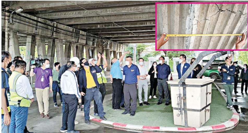
▲ สะพานร้าว...กรมทางหลวง ลงตรวจสอบสะพานทางด่วนพระราม 2 บริเวณทางเข้าหมู่บ้านเนเชอรัล พบรอยแตกกว้างและการหลุดร่อนที่แผ่นพื้นสำเร็จรูป (ภาพเล็ก) เร่งซ่อมยันไม่กระทบโครงสร้างหลัก (ข่าวหน้า 13)
