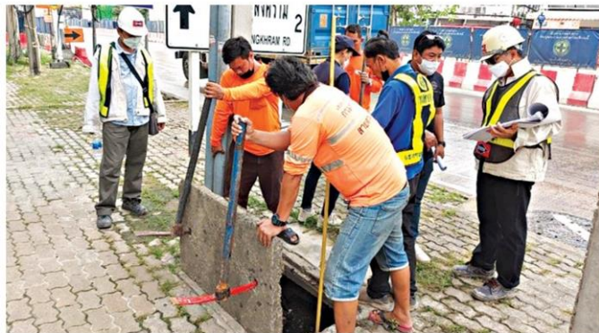
ลอกท่อ... การรถไฟฟ้าขนส่งมวลชนแห่งประเทศไทย (รฟม.) ในฐานะหน่วยงานกำกับโครงการรถไฟฟ้าสายสีชมพูช่วงแคราย-มีนบุรี พร้อมแขวงทางหลวงชนบทบุรี ลอกท่อถนนติวานนท์แนวก่อสร้างโครงการฯเพิ่มประสิทธิภาพการระบายน้ำรวมทั้งติดตั้งเครื่องสูบน้ำถนนรามอินทราขอย 5 จุดเสี่ยงน้ำท่วม
