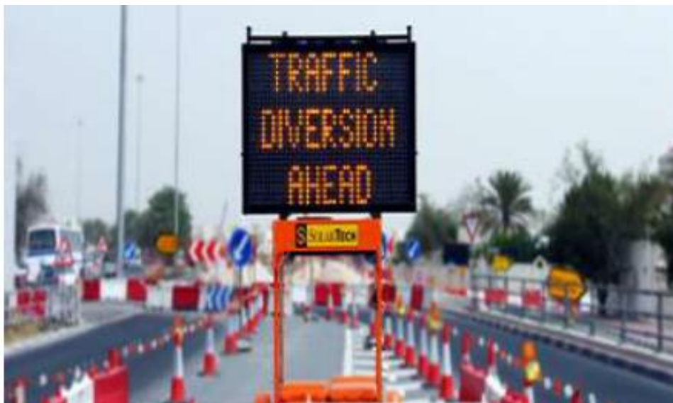
รูปที่ 3-13 อุปกรณ์จราจรประเภทป้ายสัญญาณแบบปรับเปลี่ยนข้อความ (Portable Changeable Message Sign)
