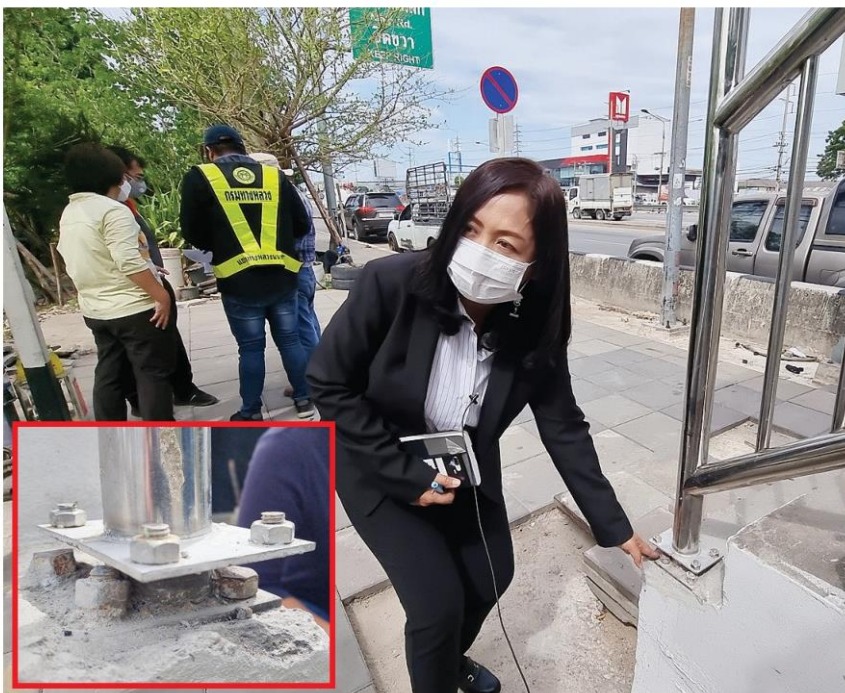
◀ นอตทิพย์ - จนท.ตรวจสอบนอตบันไดสะพานลอยหน้าโรงเรียนพระแม่สกลสงเคราะห์ ต.พิมลราช อ.บางบัวทอง จ.นนทบุรี พบว่าไม่ได้ยึดติดอย่างมั่นคงถูกต้องตามแบบ จึงสั่งผู้รับเหมาเร่งแก้ไขด่วน เมื่อวันที่ 29 มิ.ย.
