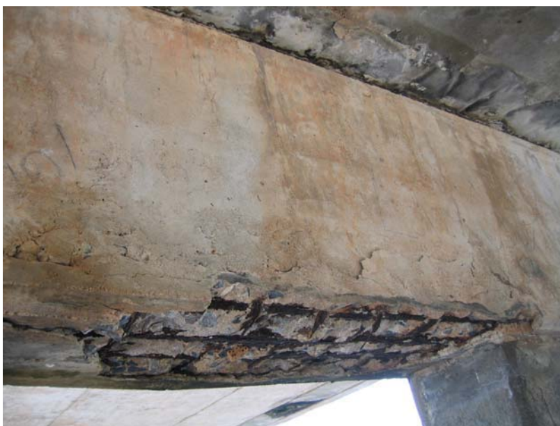
รูปที่ 2-4 การหลุดแยกออกเป็นแผ่นๆ ใต้คานขวางบนตอม่อสะพาน
