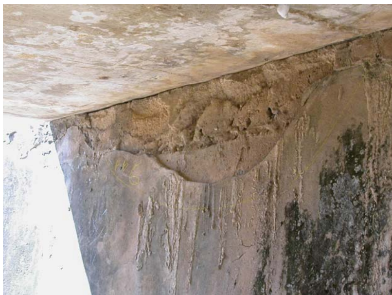
รูปที่ 2-2 การหลุดเซาะบริเวณคานขวางของตอม่อสะพาน
