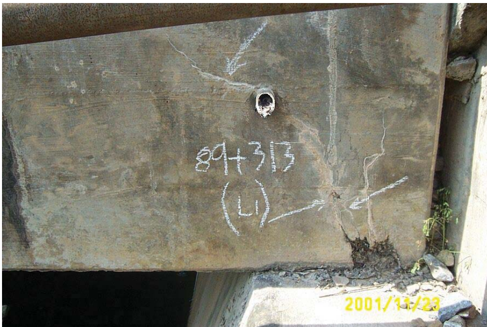
รูปที่ 2-2 รอยแตกเนื่องจากแรงเฉือนบริเวณใกล้แผ่นรองสะพาน
