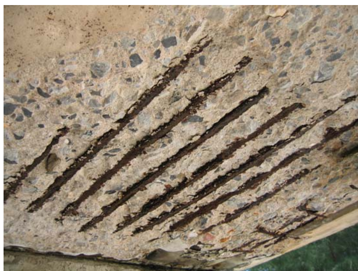
รูป 5-3 การเกิดคาน้ำในเหล็กเสริม
