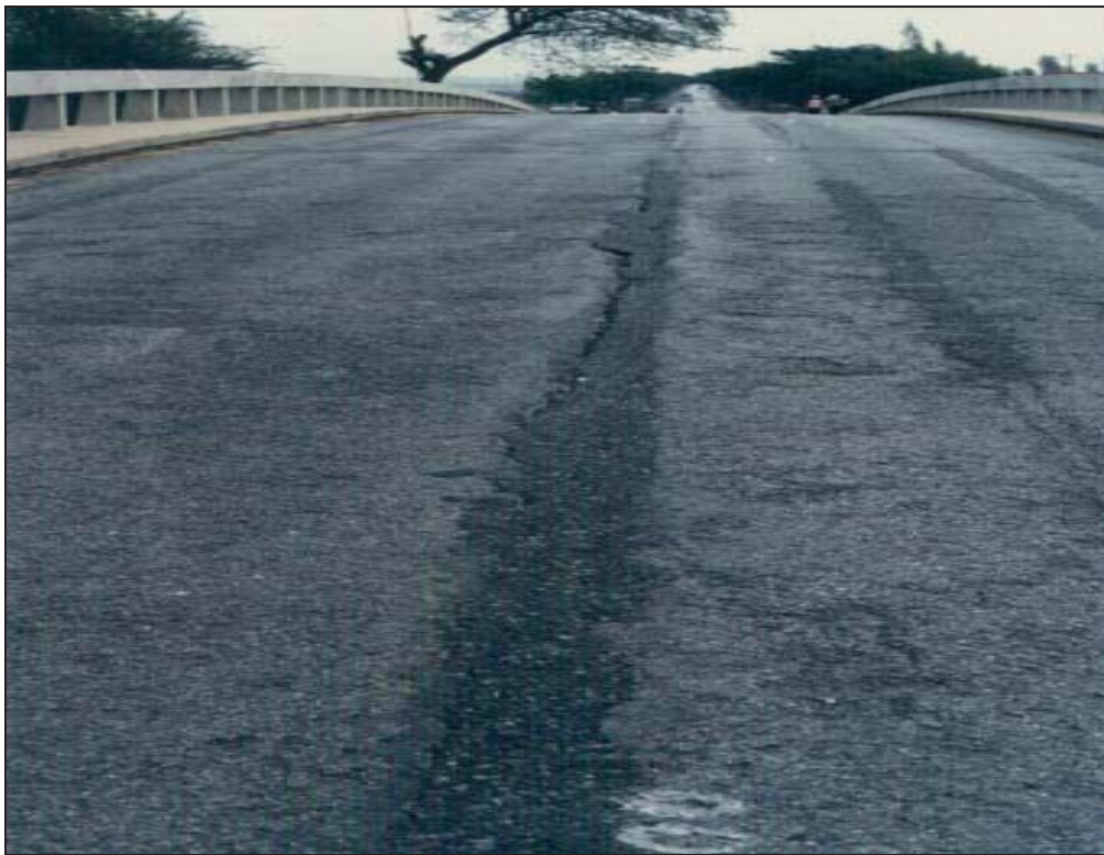
รูปที่ 3-4 รอยแตกบนพื้นสะพาน
