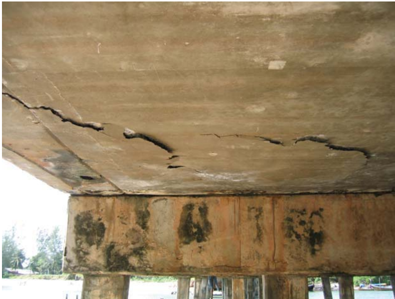
รูปที่ 2-3 การหลุดแยกออกเป็นแผ่นๆ ใต้แผ่นพื้นสะพาน
