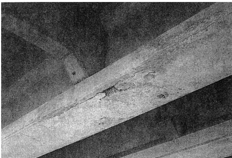
รูปที่ 6-9 รอยแตกและรอยหลุดร่อนตามแนวของคานคอนกรีตอัดแรง
