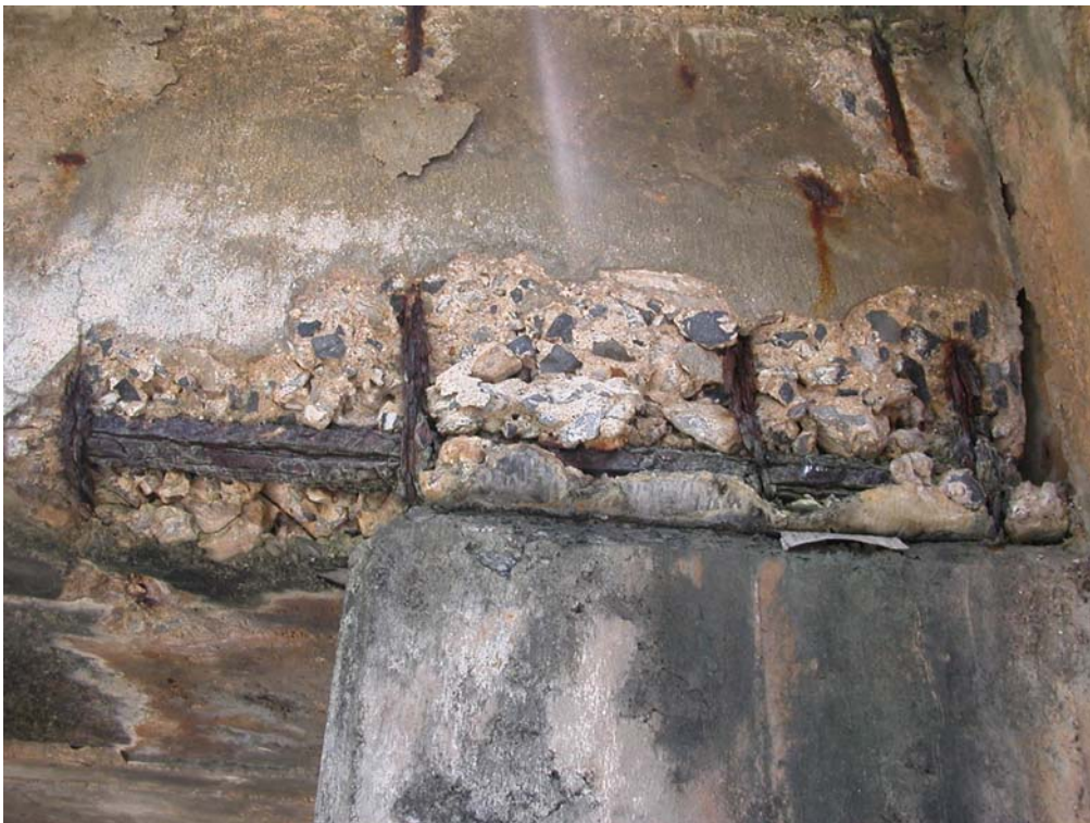
รูปที่ 3-7 คอนกรีตที่ Bent Cap ได้หลุดออกมา
