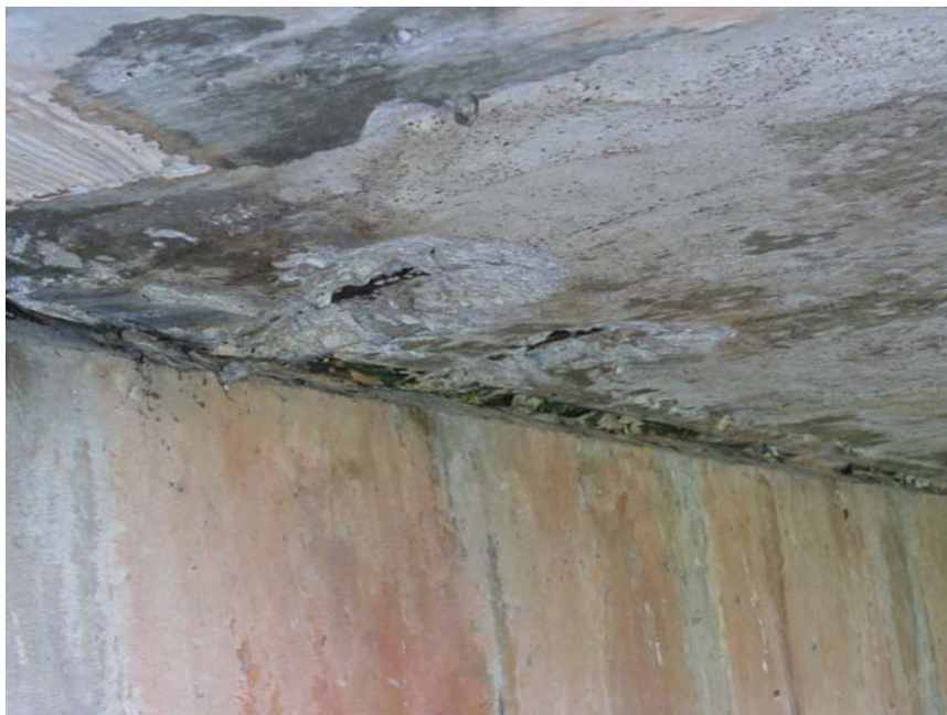
รูปที่ 2-5 การหลุดร่อนใต้แผ่นพื้นสะพาน
