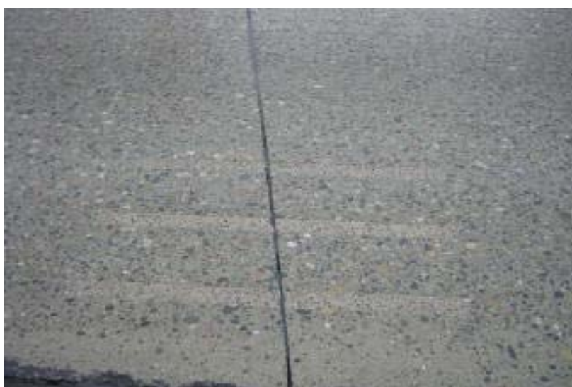
รูปที่ 3.4.5 ขัดผิวหลังการติดตั้งเหล็กเดือย
