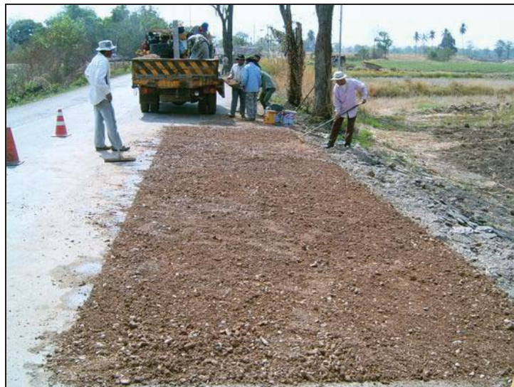
รูปที่ 2.6.4 นำวัสดุชั้นทางที่เหมาะสมมาก่อสร้างตามข้อกำหนด
