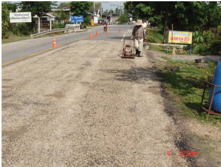
รูปที่ 2.3.6 การเลือกเครื่องมือที่ไม่เหมาะสม จะทำให้แอสฟัลต์เซ็ทตัวก่อนที่จะทำการบดทับแล้วเสร็จ
