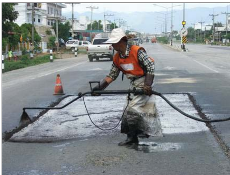
รูปที่ 2.7.1 Tack Coat บนผิวทางเดิมที่ได้กำหนดขอบเขตพื้นที่และทำความสะอาดแล้ว
