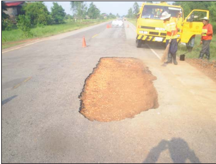
รูปที่ 2.5.3 รอยตัดที่ไม่ได้มาตรฐาน
