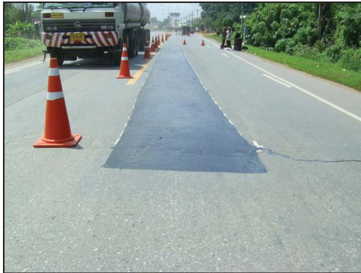
รูปที่ 2.2.3 ผิวทางเมื่อทำการฉาบผิวทางแบบฟ็อกซีลเสร็จ รอเปิดจราจร
