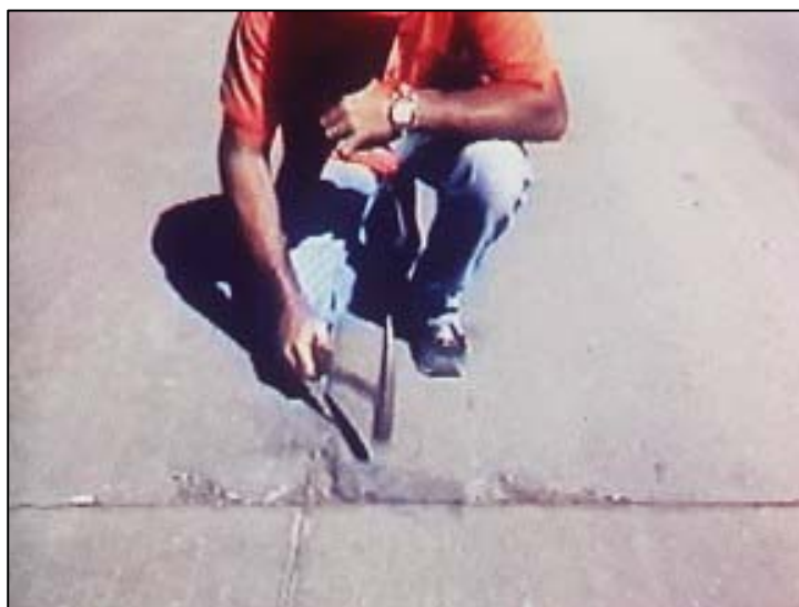
รูปที่ 3.5.1 ตรวจสอบความเสียหายของคอนกรีต
