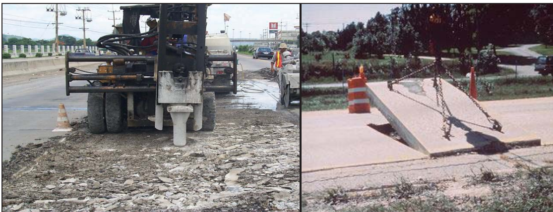
รูปที่ 3.7.3 นำแผ่นพื้นคอนกรีตออกโดยวิธีทุบให้แตกหรือวิธียกออก
