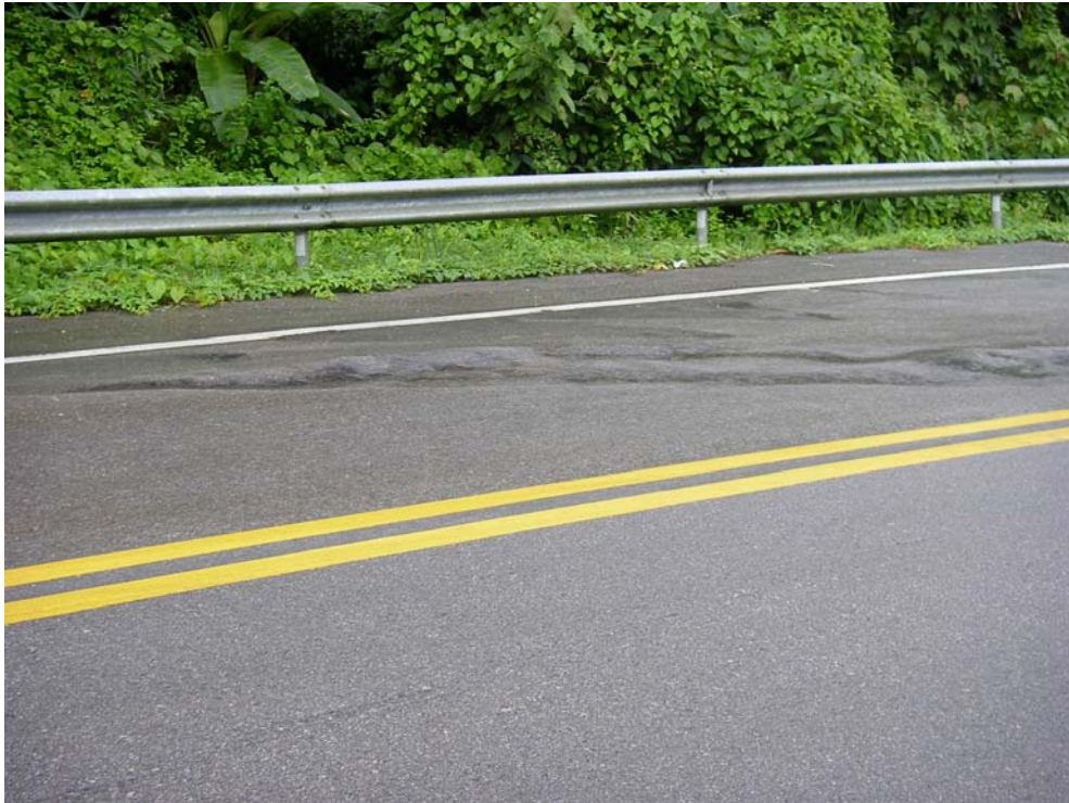
รูปที่ 1.12 การชำรุดของผิวถนนบริเวณเขตห้ามแซง
