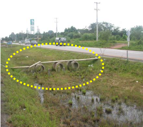
รูปที่ 1.6 อันตรายจากการตัดแปลงพื้นที่เกาะกลางเป็นทางเชื่อม
