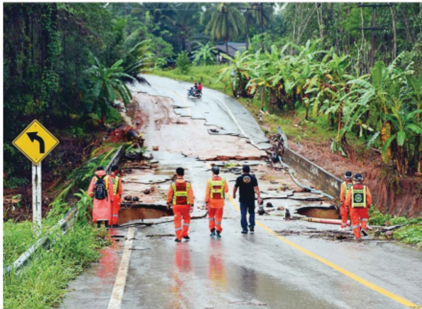
△ ฤทธิ์น้ำป่า - จนท.ตรวจสอบความเสียหายสะพานข้ามคลองหมู่บ้านช่องลม ต.ช้างแสด อ.บางสะพานน้อย จ.ประจวบคีรีขันธ์ ที่ถูกน้ำป่าซัดพังเสียหาย ชาวบ้านระบุเหตุนี้ท่วมครั้งนี้นหนักที่สุดในรอบ 30 ปี เมื่อวันที่ 11 พ.ย.
